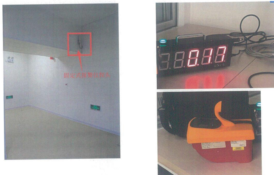
图 4-4 加速器机房剂量报警系统设置情况
