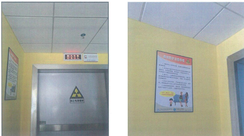
图 4-5 CT 模拟定位机房安全防护设施
